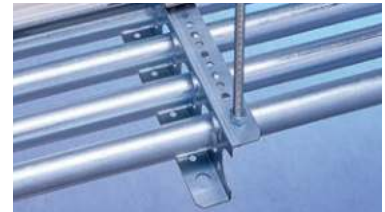
Conduit trapeze support
